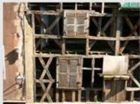
Un immeuble abandonné se dégrade très vite.
