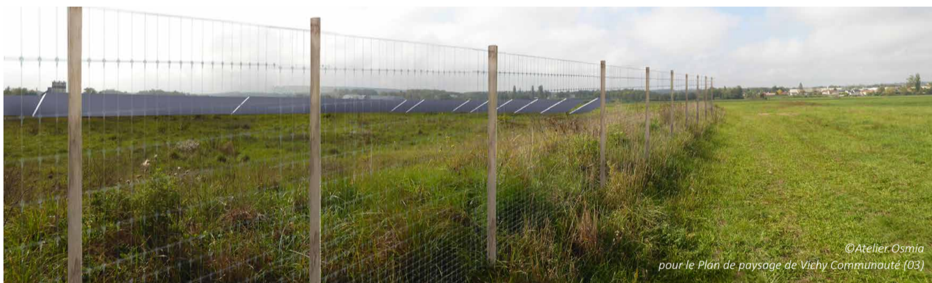
Ci-dessus, simulation d'une clôture en piquets en châtaignier et grillage à maille progressive (ursus lourd), dont le bois s'harmonise dans le contexte agricole et naturel. A l'arrière d'un projet de parc photovoltaïque simulé sur une friche. Hauteur 2m
