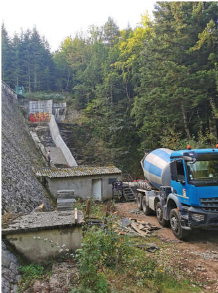
Eau potable : Traitement des affouillements en pied aval et des fissures en crête du barrage de la Muratte
